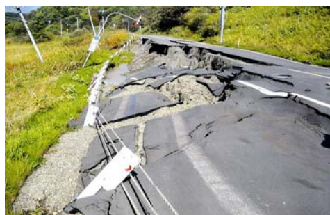
平成15年十勝沖地震（豊頃町）
