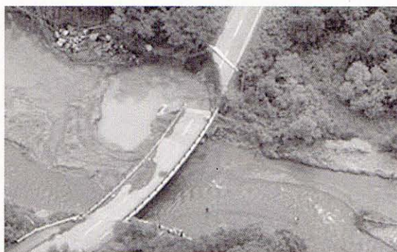
崩落した東居辺橋
