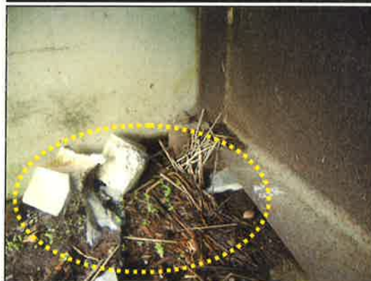
写真2：橋座の土砂堆積の例
