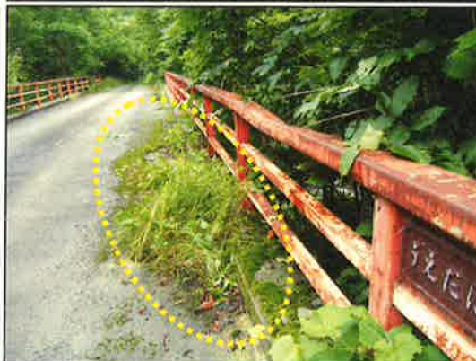
写真1：路面の土砂堆積の例
