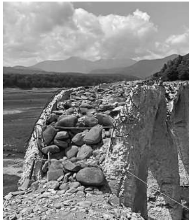
中の砂利が露出している様子
